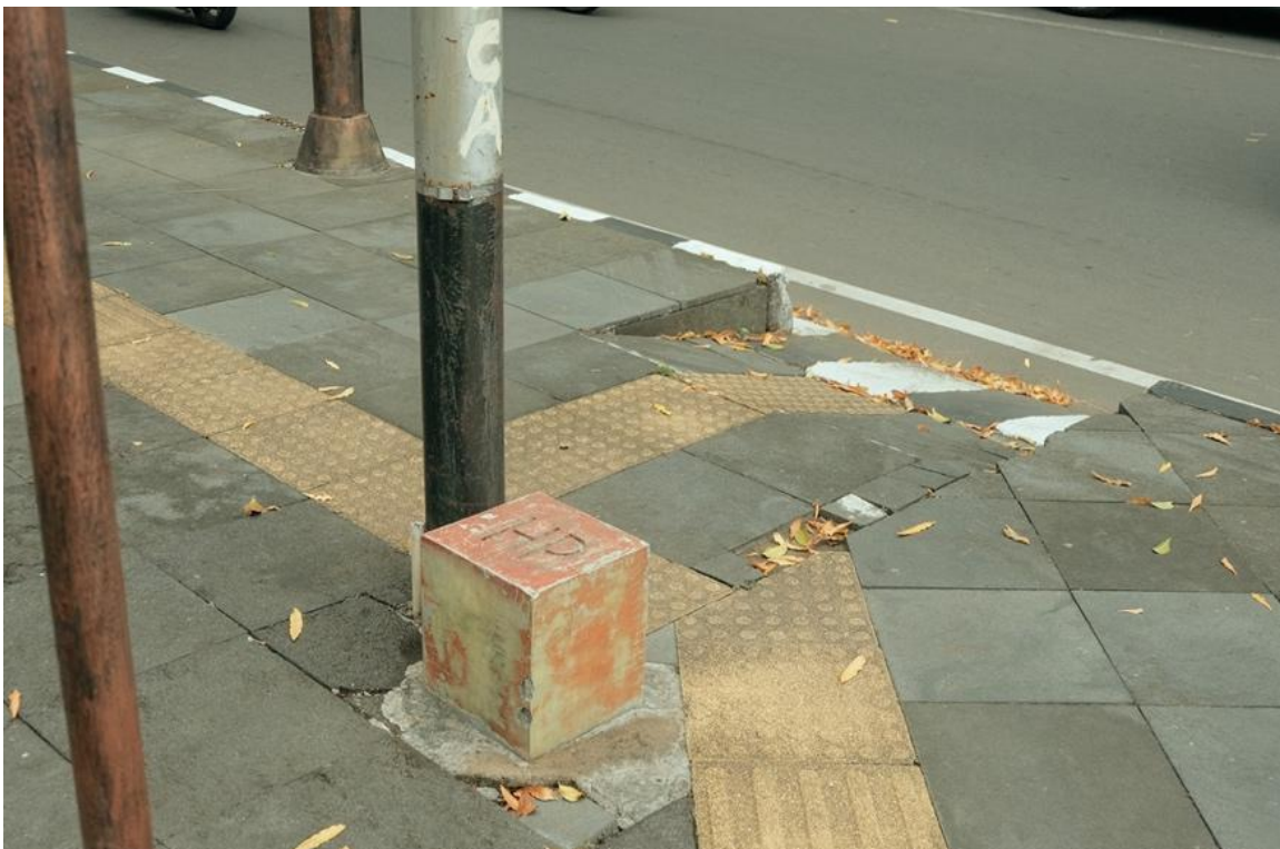
Kesalahan pada pemasangan ubin pemandu di area City Walk (Jl. Slamet Riyadi)
