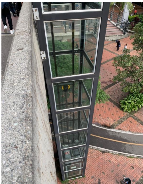
Ascensor en una estación del Metro
